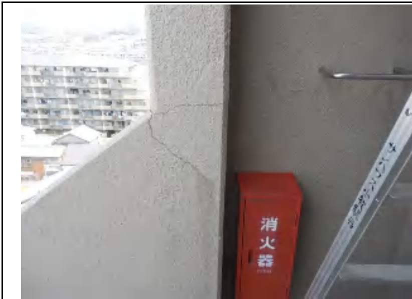
写真 No. 4 屋上連絡階段 手摺内壁 ひび割れ
