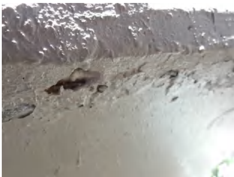
写真 No.36 7-C 南バルコニー 出窓面台裏 露出鉄筋
