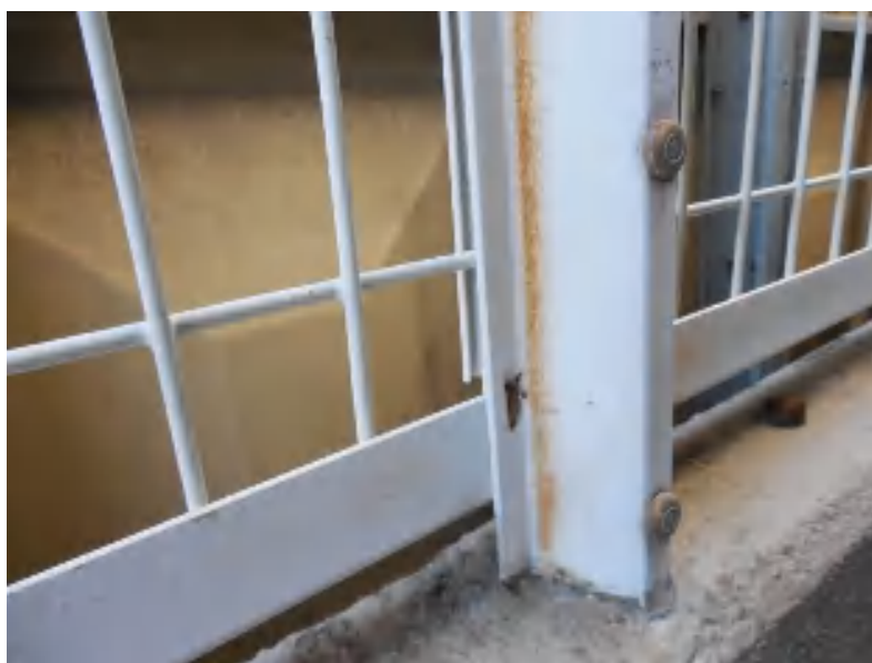
写真 No.75 受水槽 フェンス 錆、塗膜のチョーキング
