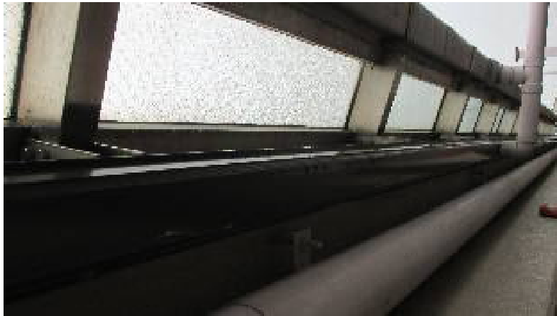
写真 No.154 9F 廊下ガラス庇 塩ビ製樋+庇取合い部 雨だれ(雨漏れ)
