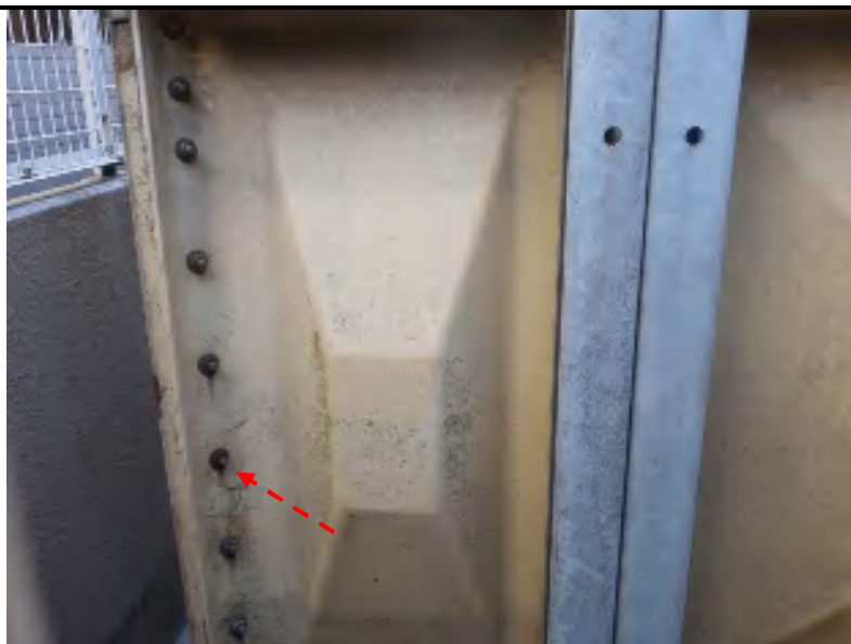
写真 No.74 受水槽 ボルト 錆の発生
