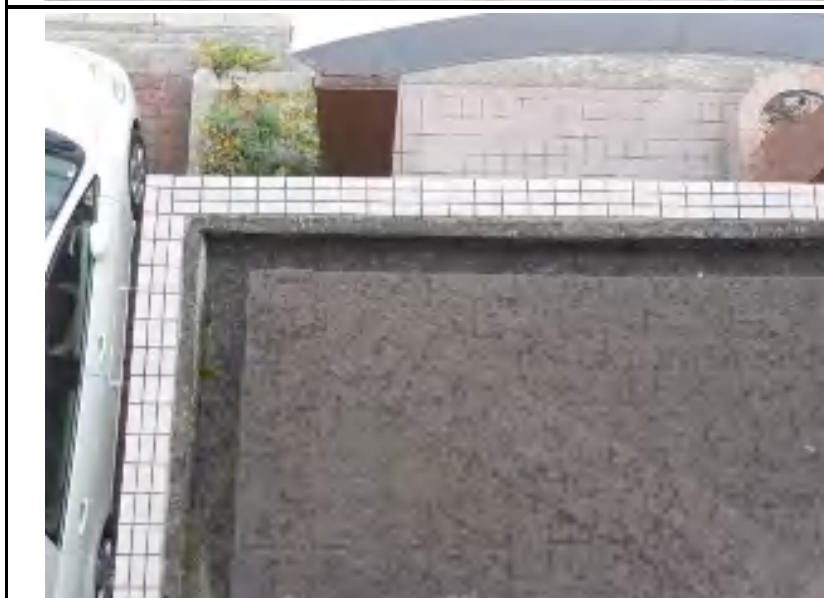
写真 No.116 同 アスファルトシングルルーフの経年劣化
