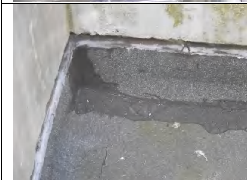
写真 No.93 同 平場、立上り シートの経年劣化
