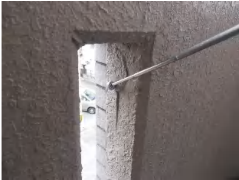
写真 No.34 3-A 南バルコニー 手摺壁スリット部 爆裂
