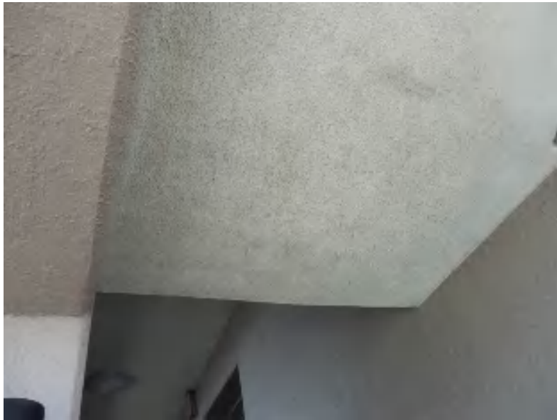
写真 No.43 西共用階段 段裏 塗膜(リシ)の汚染
