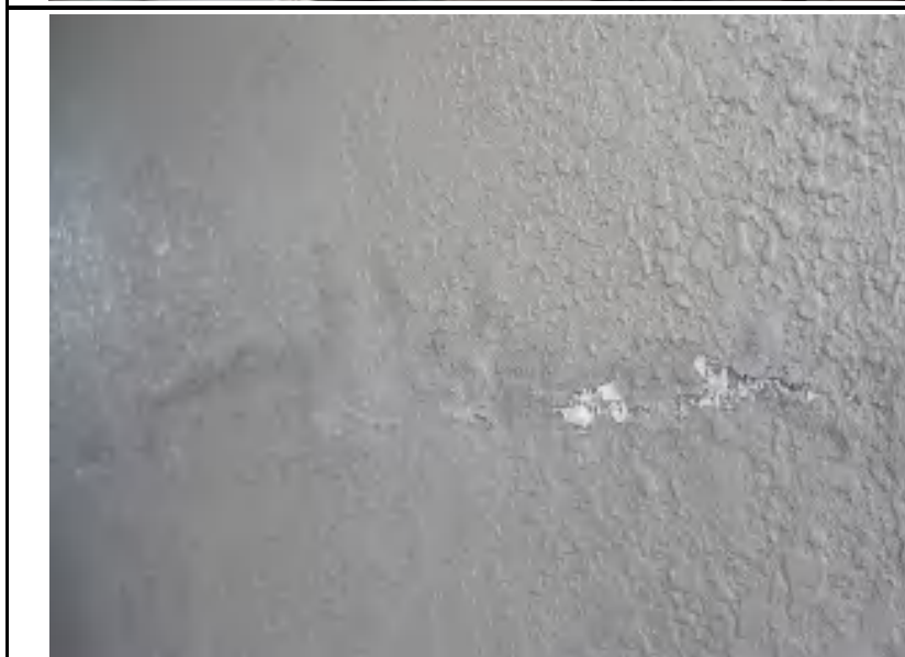
写真 No.41 9 8 階西共用階段 内壁 塗膜の剥がれ
