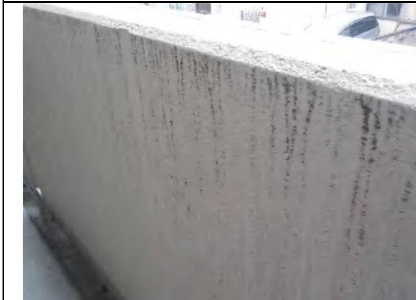
写真 No.54 2-A 南バルコニー 手摺内壁 塗膜の雨筋汚染
