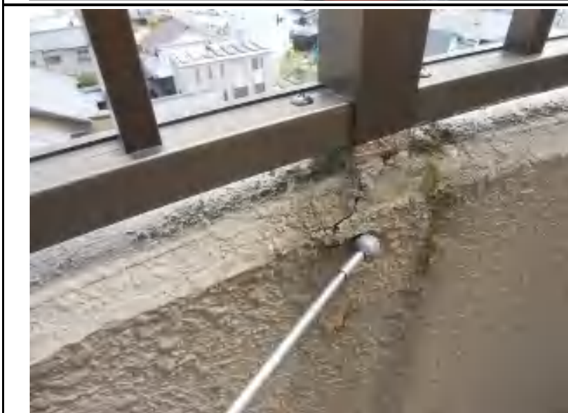
写真 No. 5 9階共用廊下 手摺支柱根本 爆裂
