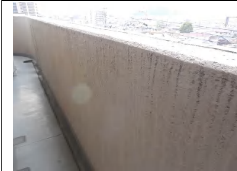
写真 No.52 7-E 南バルコニー 手摺内壁 塗膜の雨筋汚染
