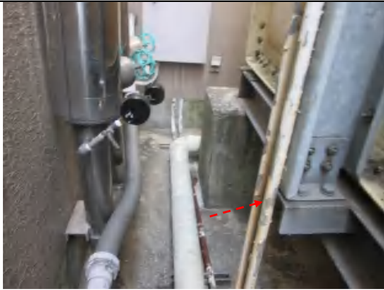
写真 No.73 受水槽 配管 塗膜の剥がれ
