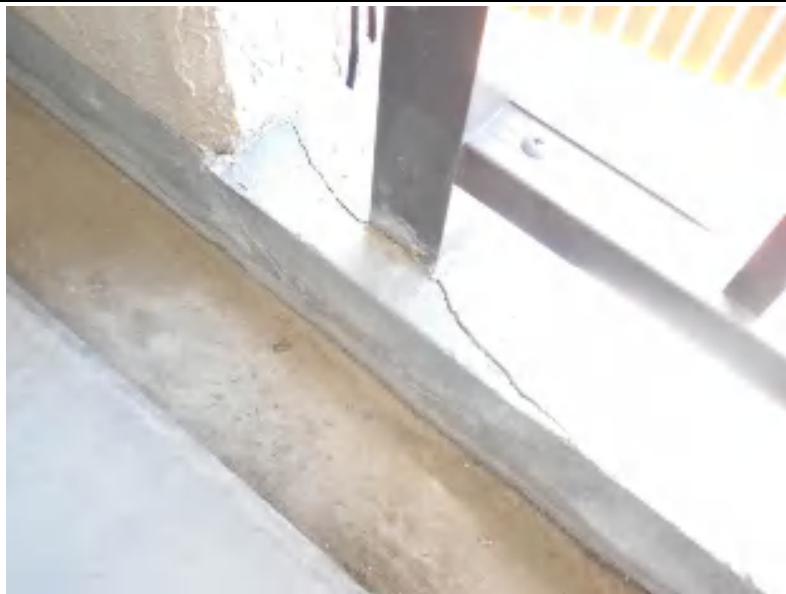
写真 No.35 7-B 南バルコニー 手摺基礎天端 ひび割れ
