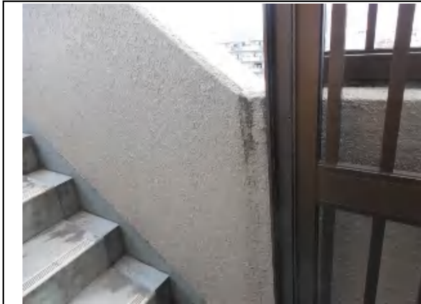
写真 No.40 屋上連絡階段 手摺内壁 塗膜の汚染(藻・カビ)
