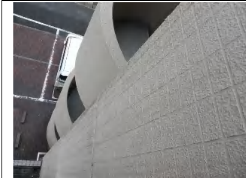
写真 No.53 3-A 西バルコニー 西面外壁 塗膜の雨筋汚染
