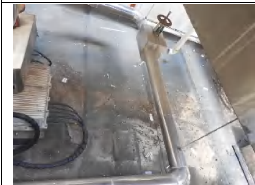
写真 No.92 同 平場 シートの経年劣化
