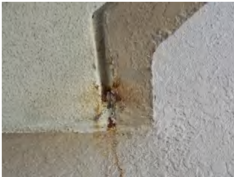
写真 No.44 7 6 階西共用階段 段裏 塗膜への汚染物付着
